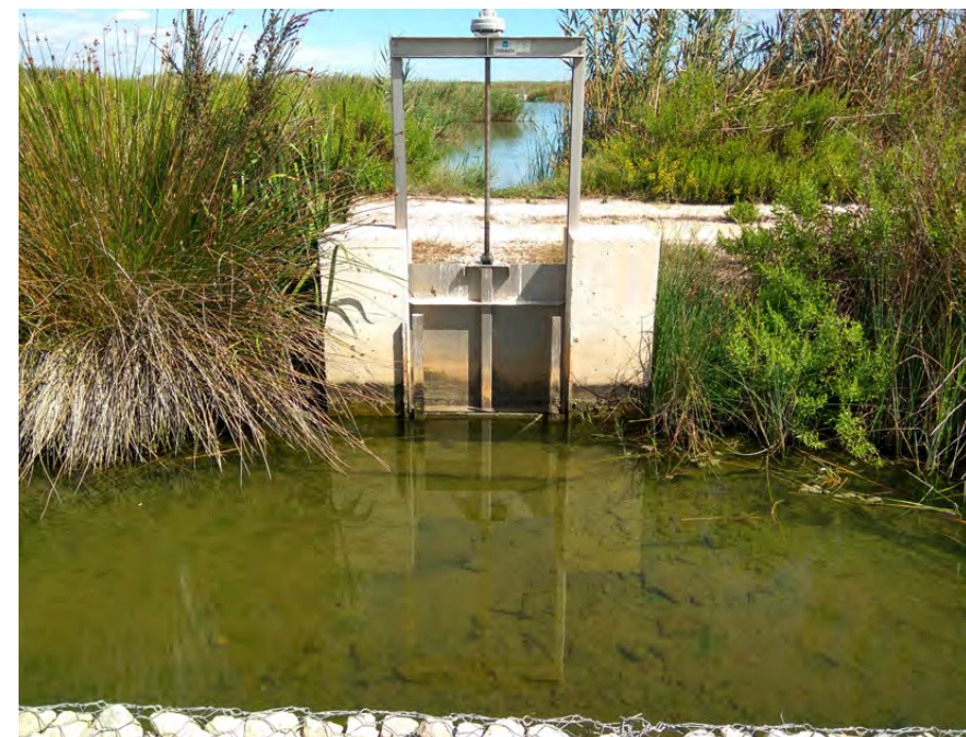
Figura 37 Compuerta para regular niveles en HATM.
