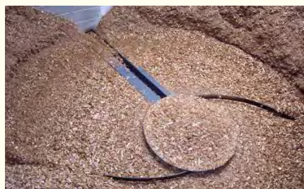
Figura 54 Depósito de alimentación de la caldera.
