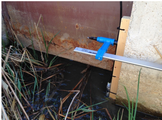
Figura 48 Sondas de presión hidrostática aguas arriba de una compuerta.
