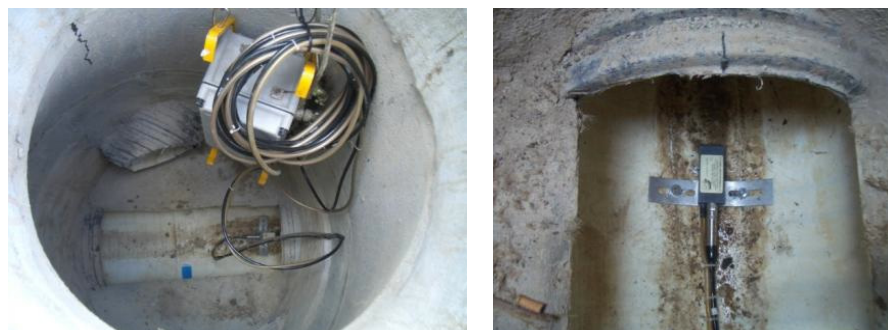
Figura 43 Equipo de ultrasonidos instalado en un tubo pasante en un pozo de registro.
