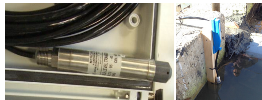
Figura 45 Sonda de presión e instalación en el tancat de la Pipa.
