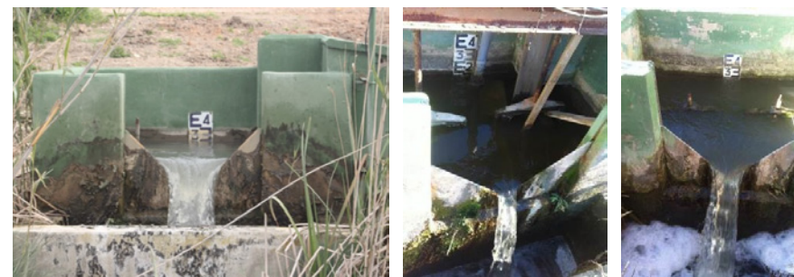
Figura 40 Arquetas de entrada al tancat de la Pipa. Vertederos triangulares en pared delgada para el aforo de caudales.
