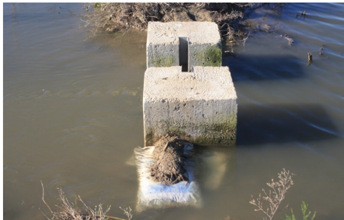
Figura 21 Ejemplo de paso de agua a través de bloques de hormigón en el que se han erosionado los laterales y se han colocado sacos de arena para obstruir el flujo.
