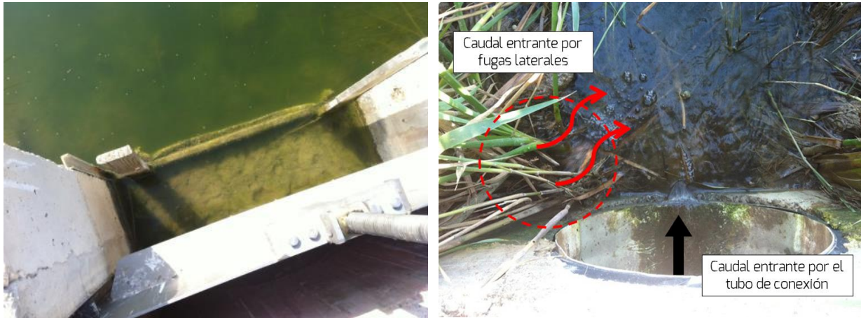
Figura 4.3. Sellado de compuertas (izquierda) y presencia de fugas bajo el tubo de conexión (derecha)
